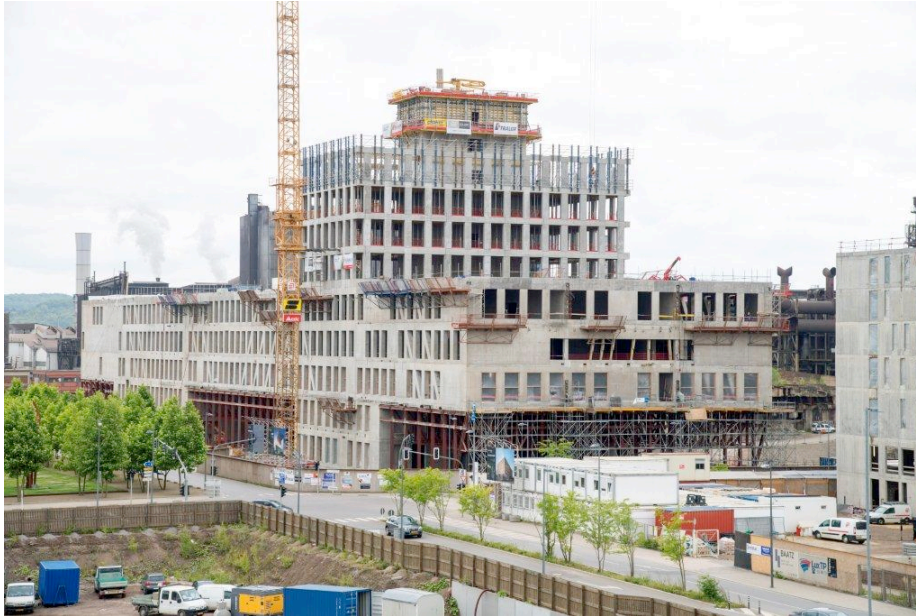
Foto 4: 2012: Dat éischt Gebai vun der Universitéit, d' Maison du Savoir , am Bau
