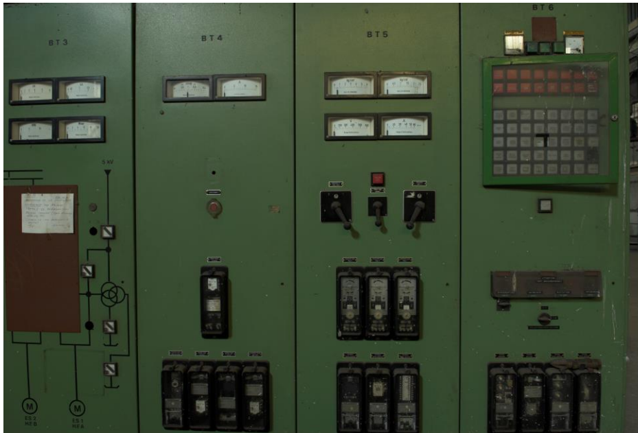
Image: Les tableaux électriques de distribution de MT:
