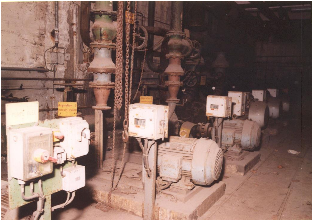
Image: Rangée de pompes dans la salle des pompes.
