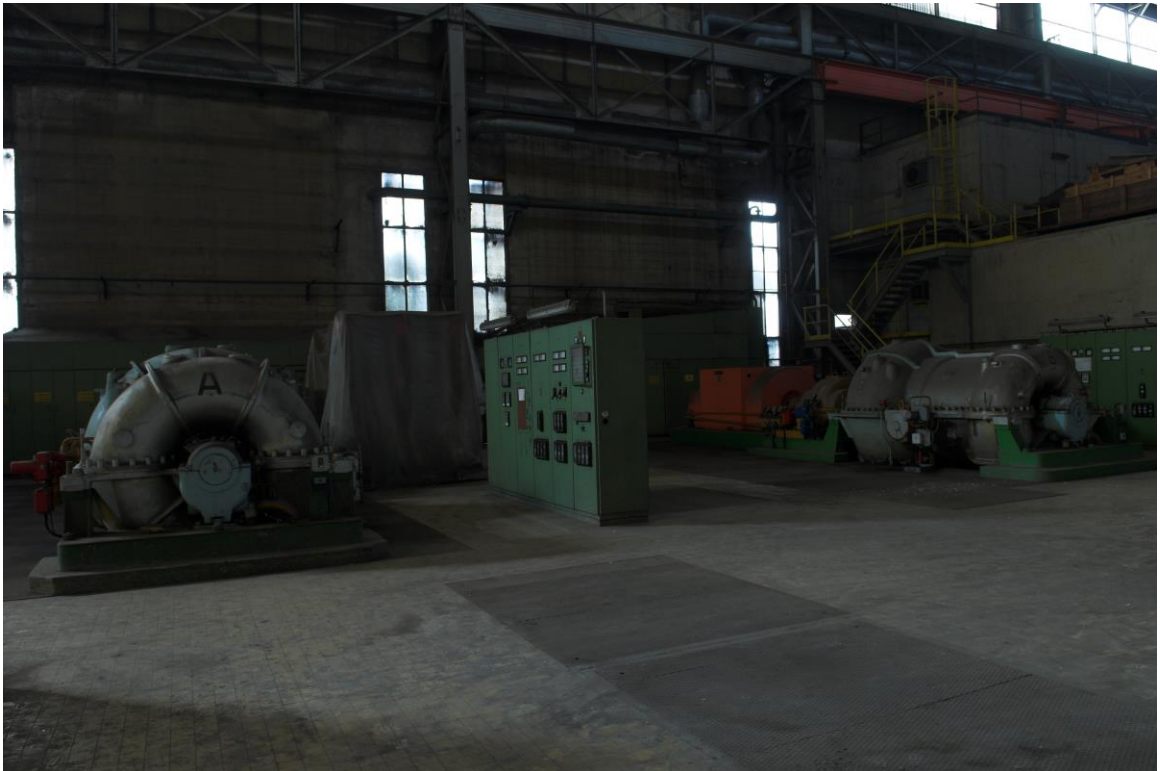
Image: 2 soufflantes avec leur équipement électrique.
