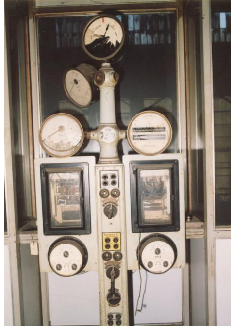
Image: Les installations de synchronisation:
