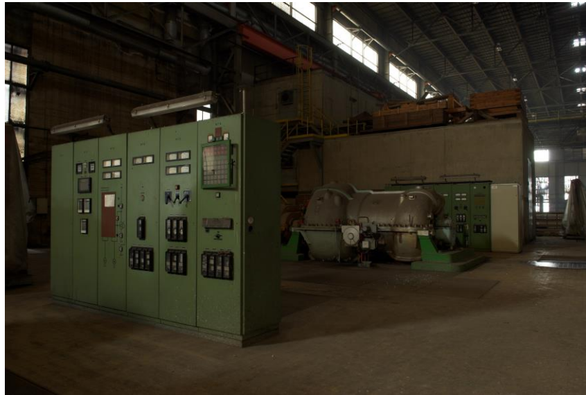
Image: Soufflante et équipement électrique.
