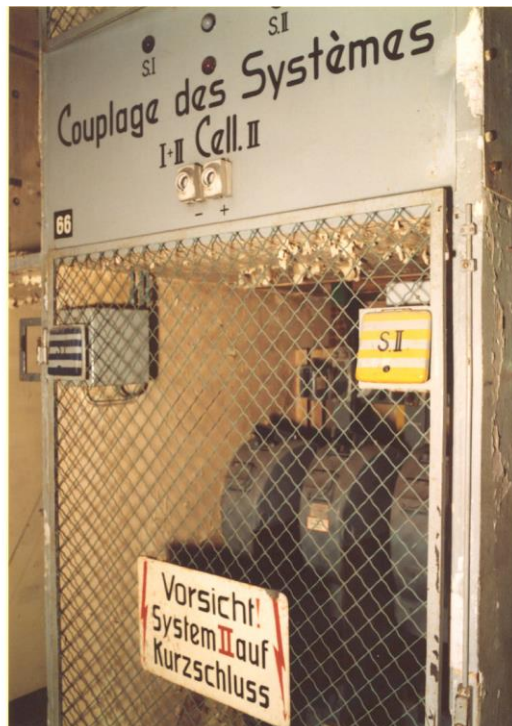
Image: Les cellules de couplage électrique de HT:
